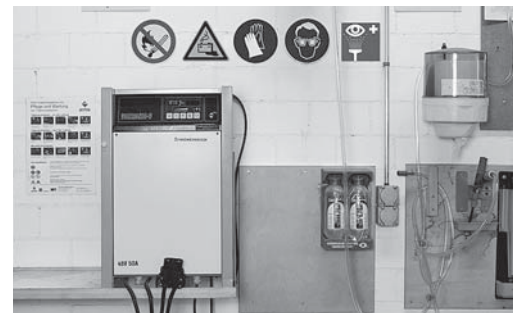
Bild 5: Vorschriftsgemäss ausgerüstete Batterieladestation mit Rauchverbot, Schutzbrille und Augendusche sind vorhanden.
